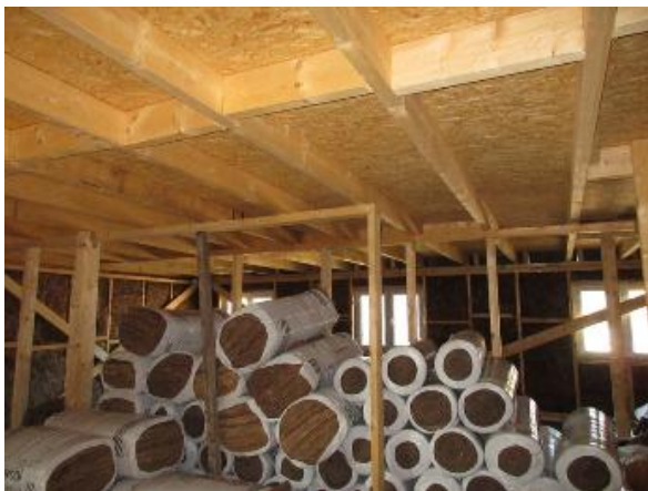
Lastkonzentration auf Decke durch Baumaterial
