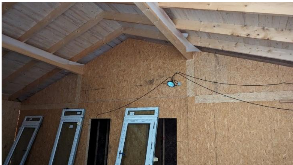
Fehlender Raumabschluss und fehlende Dachbekleidung
